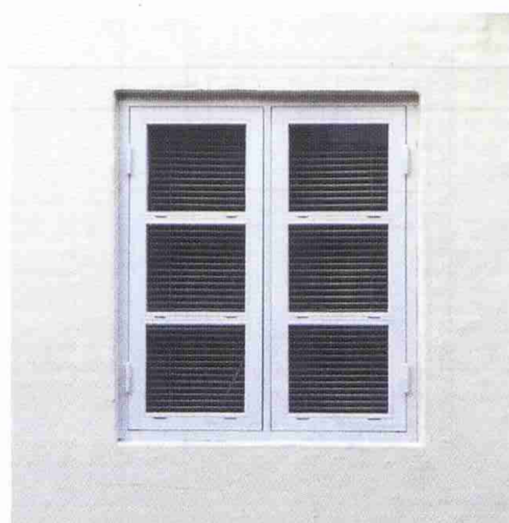
Opsproset vindue med termoruder. Små ændringer i rudeformat og sprossetykkelse med en stor virkning. Vinduet mister spændstigheden og bliver tungt og kantet at se på.
