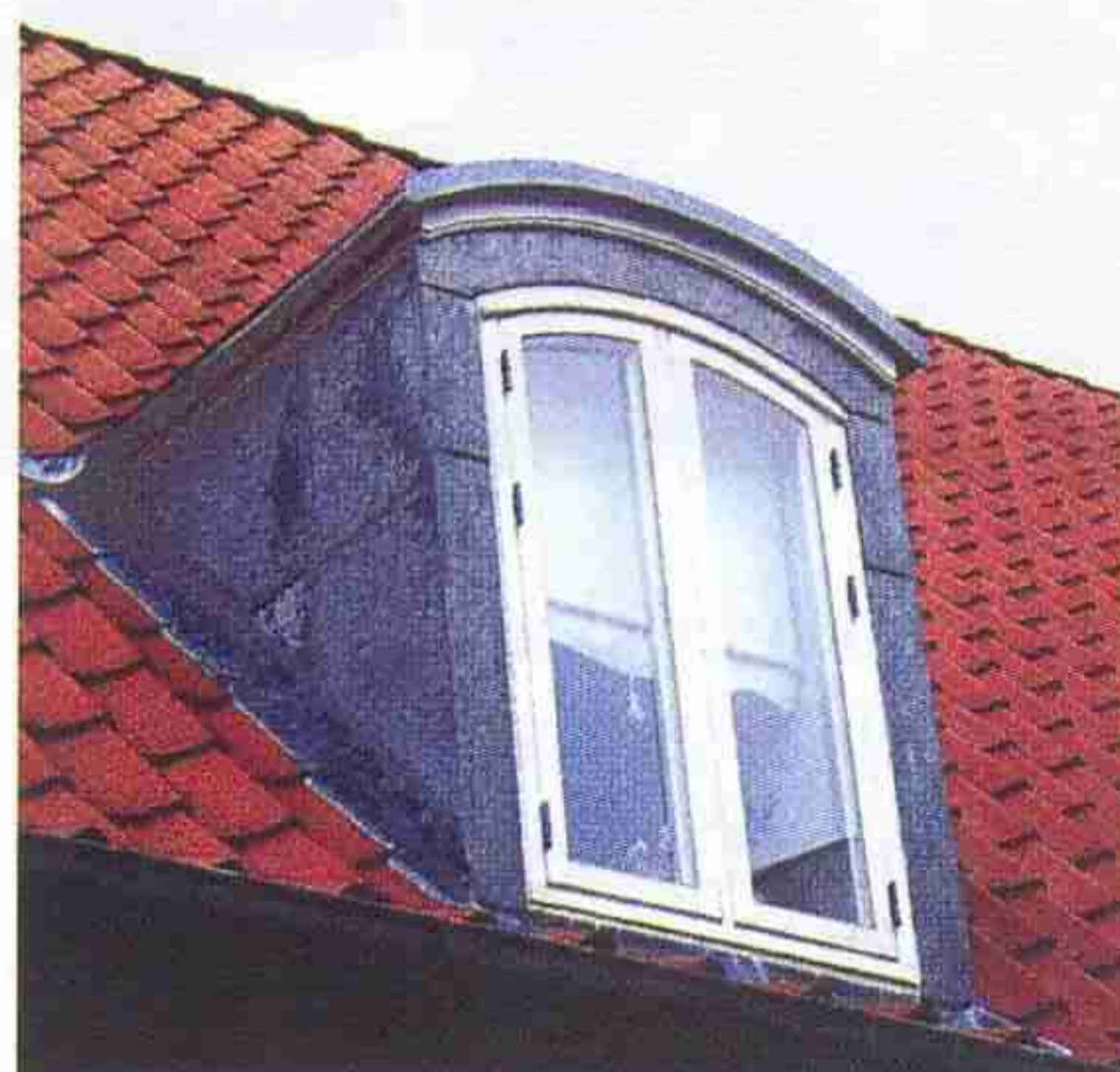
Velproportioneret nyere kvist med buet tag. Pæn og gennemført detaljering. Dog virker vinduesformatet besynderligt, og kvisten er placeret for lavt i tagfladen
